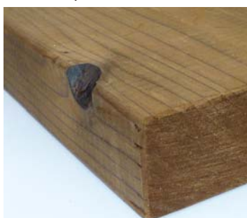
抜け節・節割れ(仕上面の角の軽微なもの)
